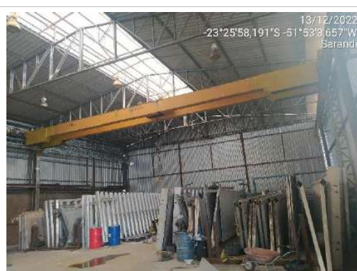
F06- Imagem do interior do barracão 01- que fica ao lado direito entrando no terreno.
