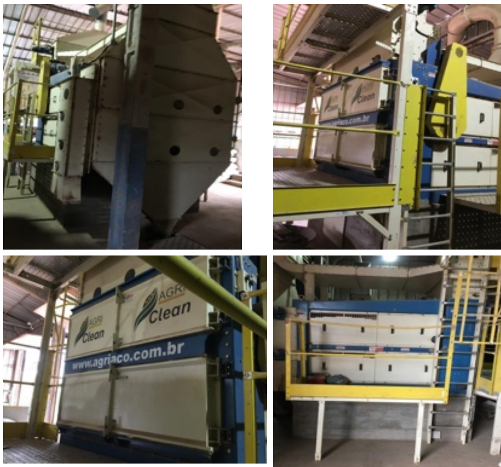
Figura nº 17 – Máquina de Pré-Limpeza dos Grãos de Soja e Milho FONTE: Acervo da empresa
